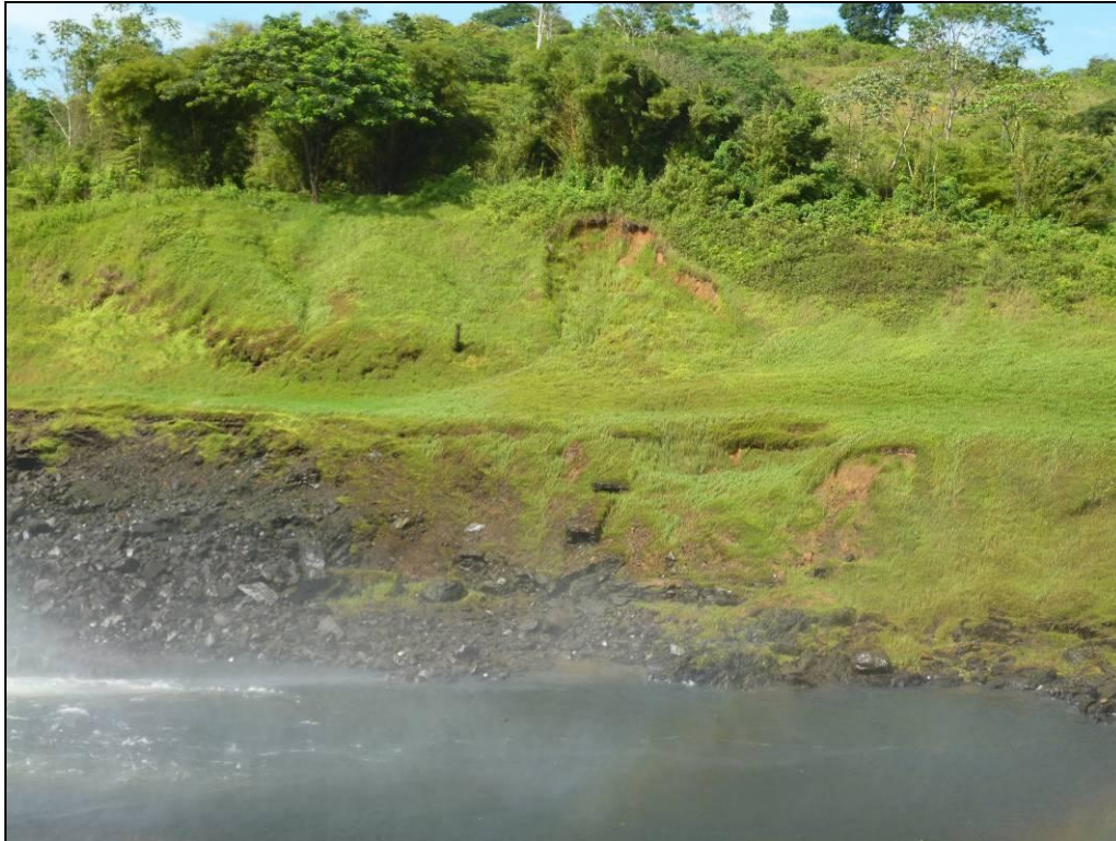
Figura 13.- Vista de deslizamientos superficiales observados al pie de la represa de Tahuín.
